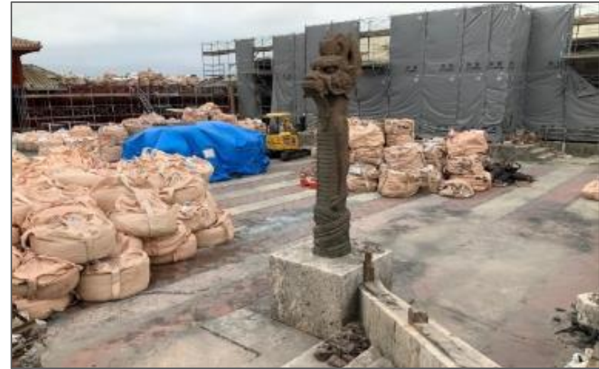
大龍柱 応急処置着手前 (R2 2/27)
