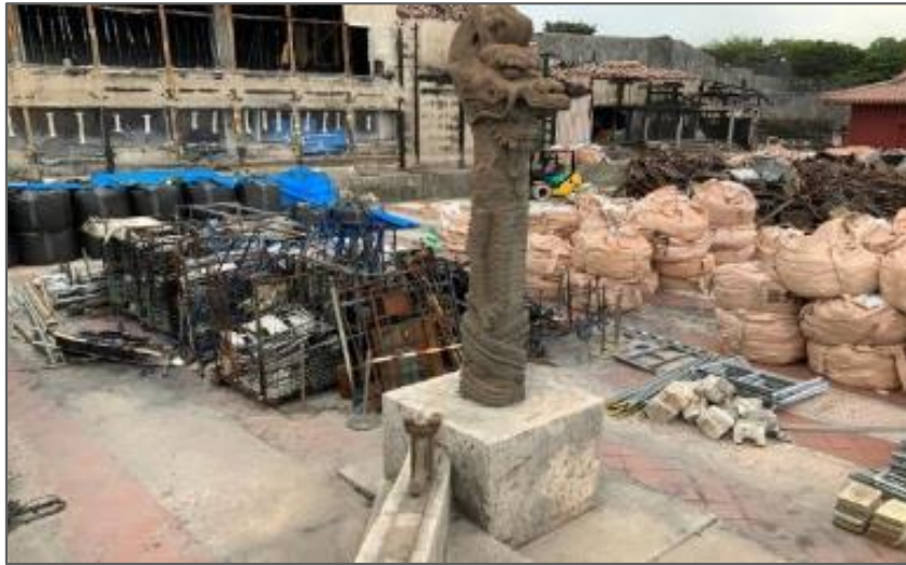
大龍柱 応急処置着手前 (R2 2/27)
