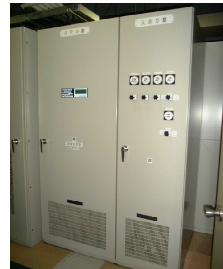
無停電電源設備
