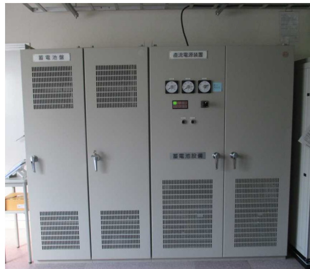
直流電源設備
