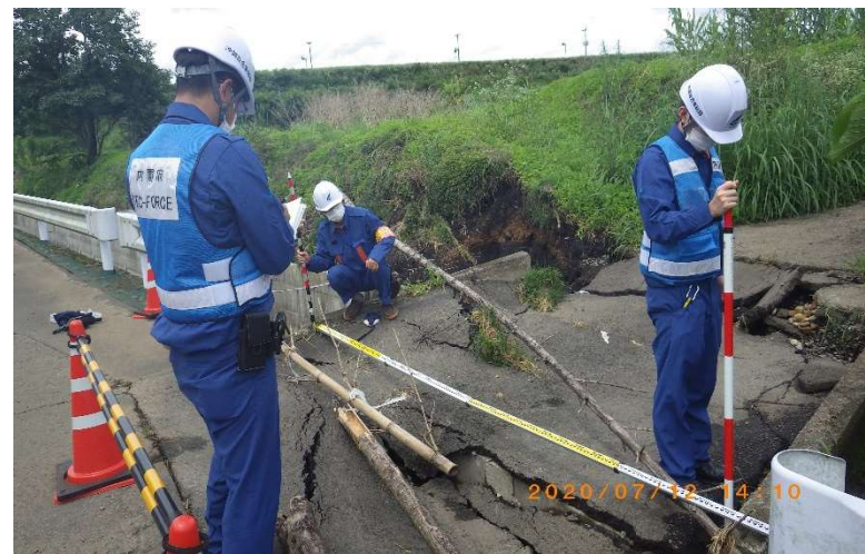
【被災状況調査(相良村)】
