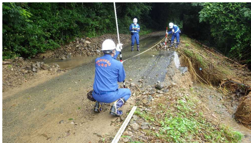
【被災状況調査】
