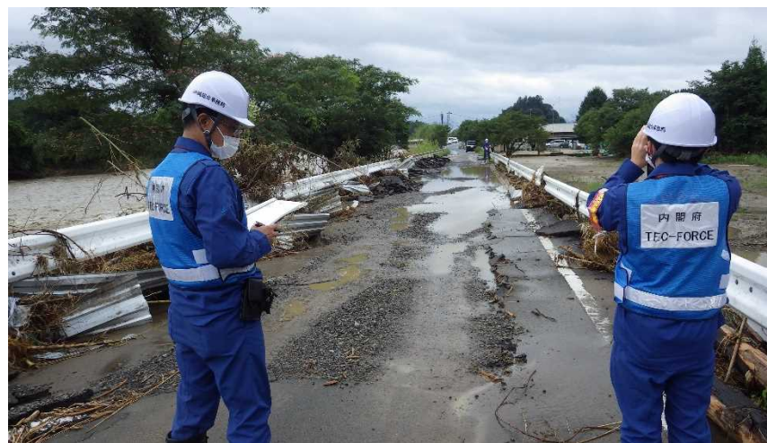
【被災状況調査】
