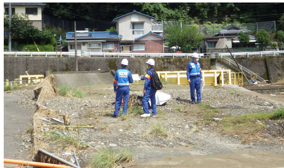
【被災状況調査(八代市)】
