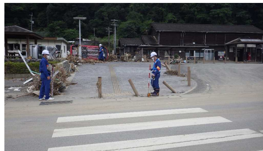
【被災状況調査(八代市坂本駅周辺)】
