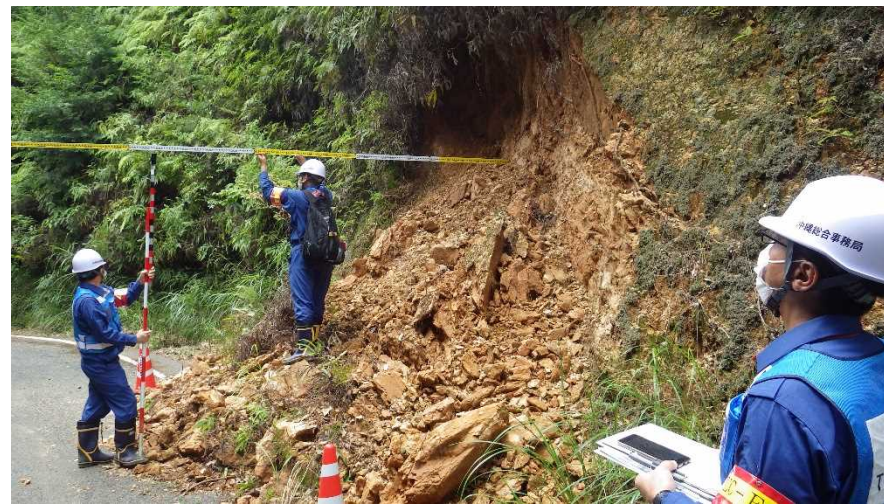
【被災状況調査：道路脇法面の崩落（八代市）】
