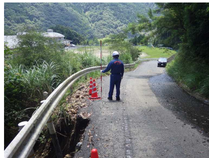
【被災状況調査:道路陥没状況(八代市)】
