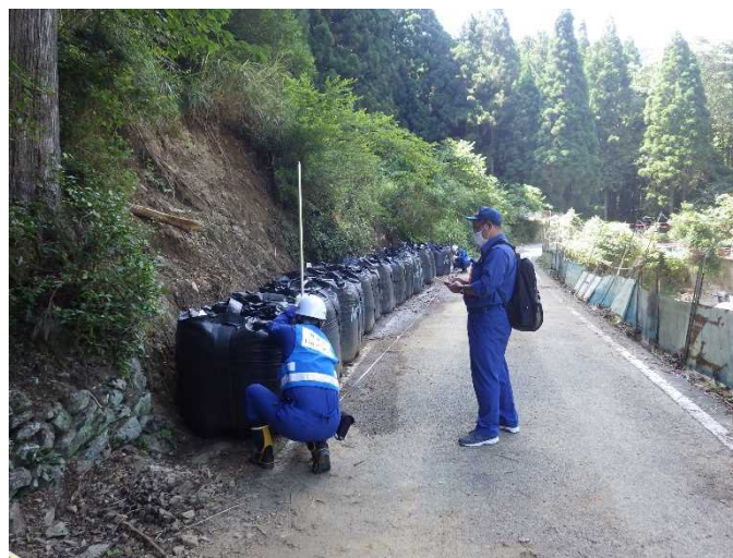
【被災状況調査:法面崩落状況(八代市)】
