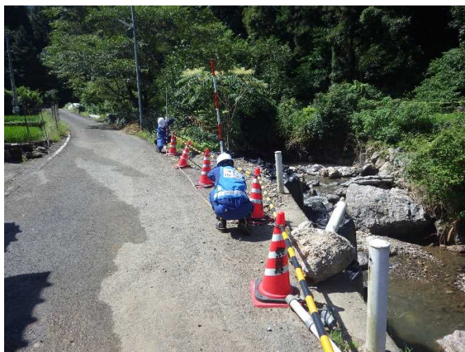
【被災状況調査:路肩崩壊状況(八代市)】
