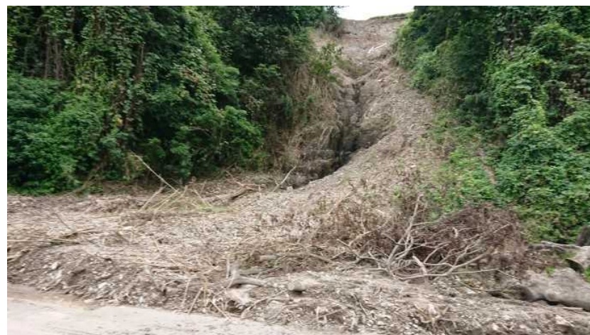
【被災状況調査:法面崩落状況(相良村)】
