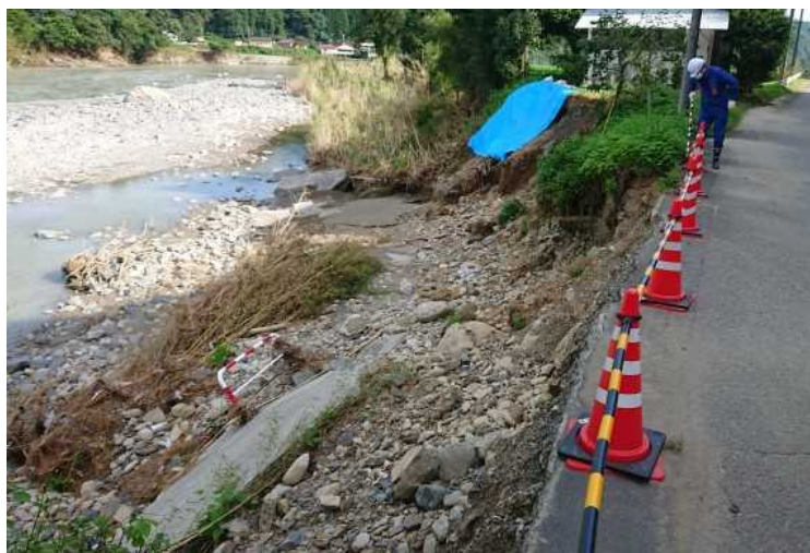
【被災状況調査:護岸崩落状況(相良村)】
