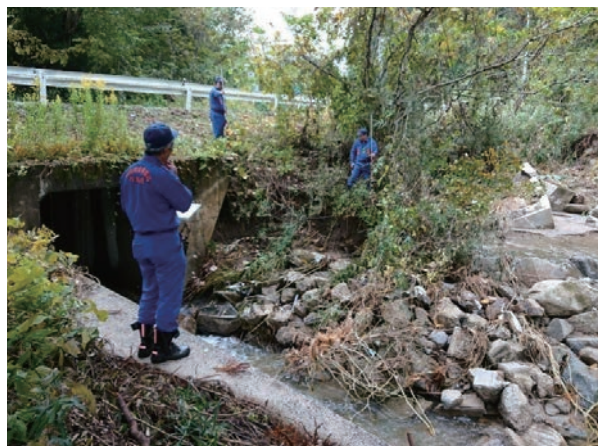
河川の被災状況調査状況(福島県伊達市 布川)
