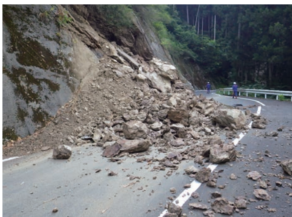
大雨により崩落した斜面を調査（愛媛県西予市）
