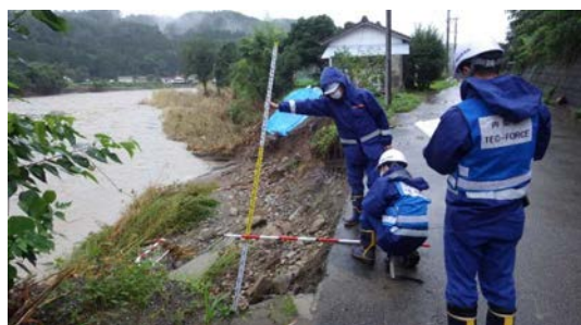
損壊した道路の調査状況（相良村）
