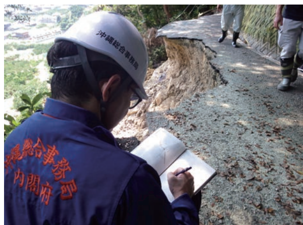
大雨により崩落した道路を調査（愛媛県西予市）
