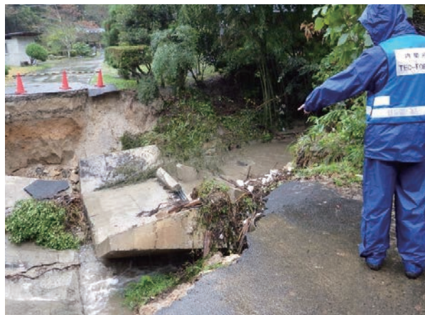
河川の被災箇所の調査(福島県伊達市 上手渡川)
