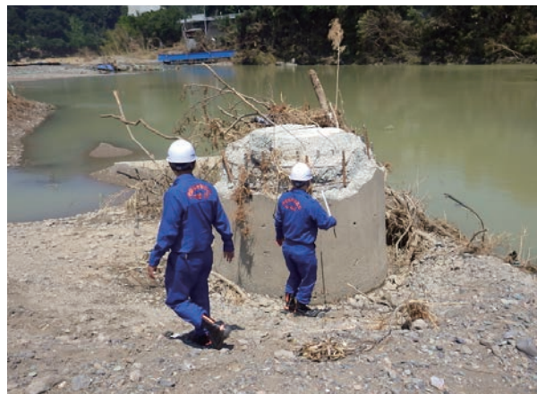
河川の増水により落橋した現場を調査（愛媛県大洲市）
