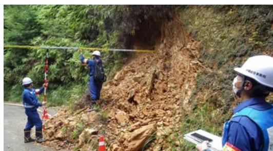
崩落した斜面の調査状況（八代市）
