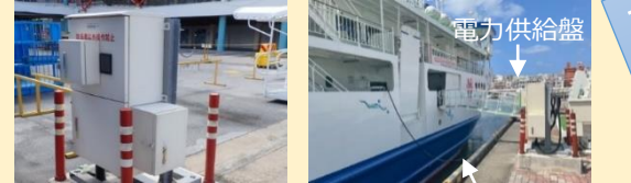
陸上電力供給施設（泊ふ頭地区）
