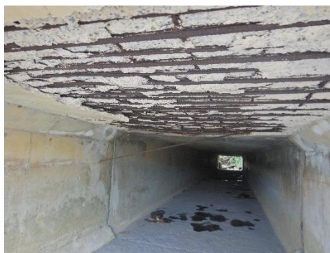
図-7 塩害により被害を受けた構造物
