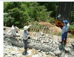
被災状況調査(現地調査)
