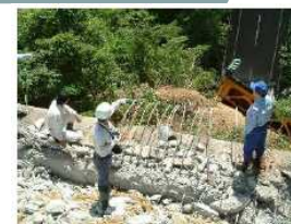
被災状況調査(現地調査)
