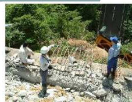
被災状況調査(現地調査)
