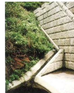
漢那ダム魚道
