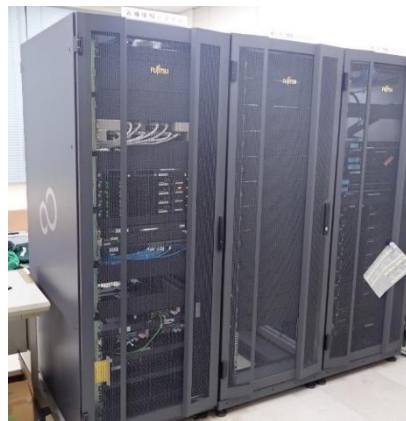
統一河川情報装置更新(ダム統管)
