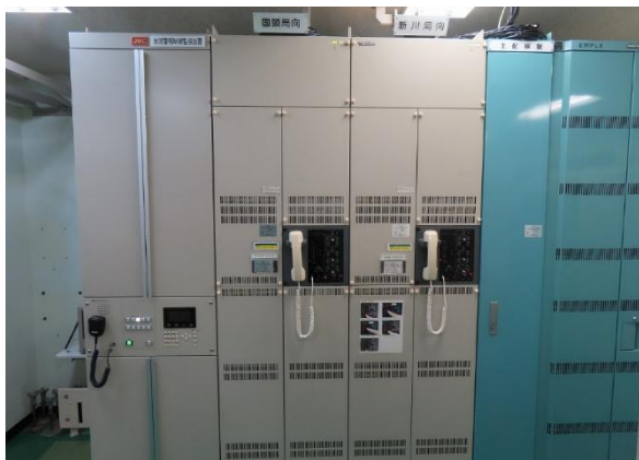
多重無線設備更新(安波ダム)
