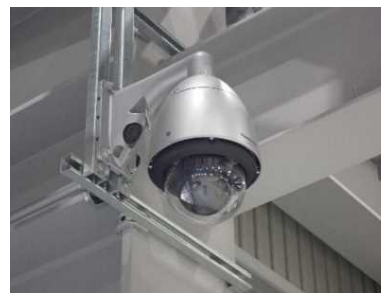
低照度型監視カメラの例 （木材倉庫内に設置）
