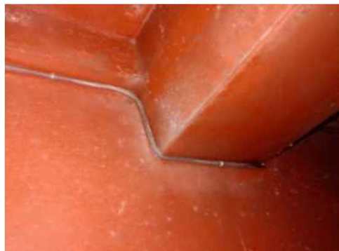
正殿内の熱感知器(空気管式)
