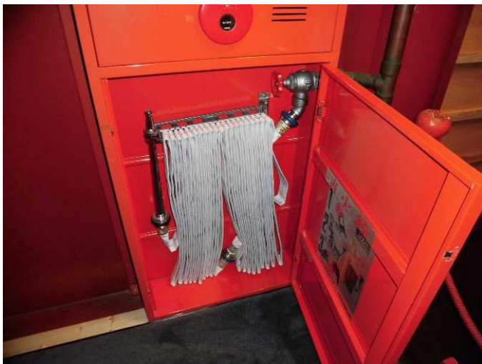
1号消火栓 <焼失前：正殿2階北側>
