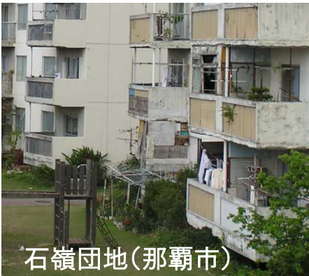
老朽化 塩害等によるコンクリート剥離が著しい
