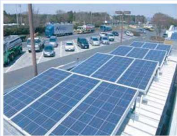
▲太陽光発電施設
