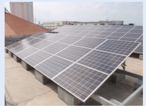
▲太陽光発電設備(道の駅豊崎)
