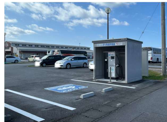
▲道の駅いとまん EV充電施設
