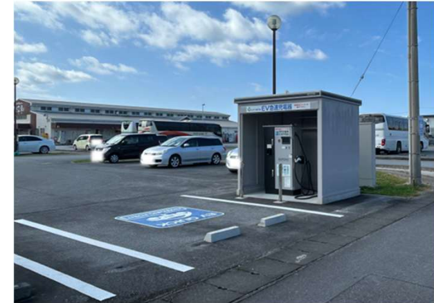
▲EV急速充電器(道の駅いとまん)
