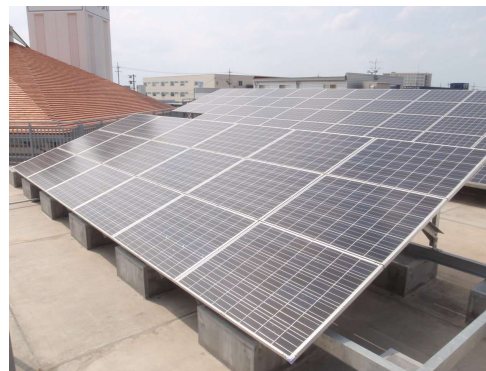
▲道の駅豊崎 太陽光発電設備施工後
