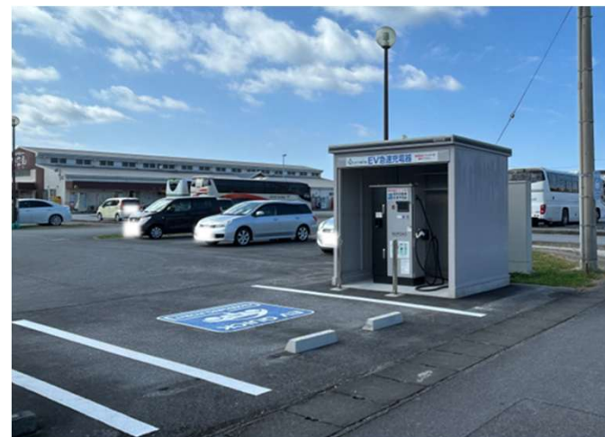
▲EV急速充電器 (道の駅いとまん)
