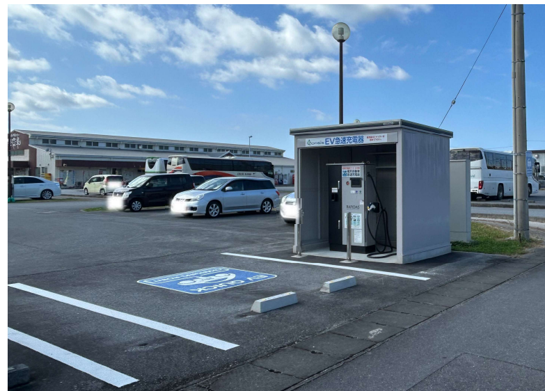
＜図 EV充電施設設置例 (道の駅(糸満市))＞
