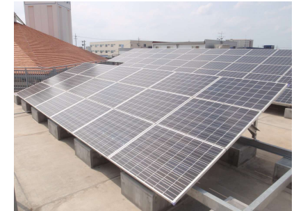
▲太陽光発電設備(道の駅豊崎)
