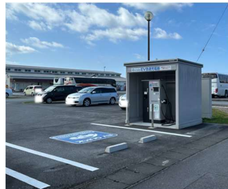
▲道の駅に設置されたEV急速充電器
