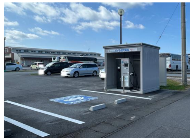
▲EV急速充電器 (道の駅いとまん)
