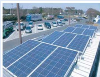
▲太陽光発電施設
