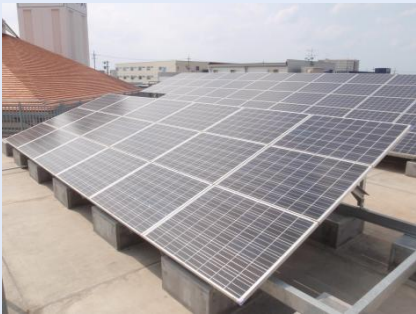
▲太陽光発電設備(道の駅豊崎)
