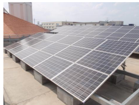
▲道の駅豊崎 太陽光発電設備施工後
