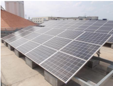
▲太陽光発電設備(道の駅豊崎)
