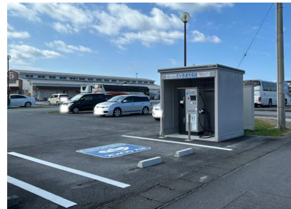
▲EV急速充電器(道の駅いとまん)
