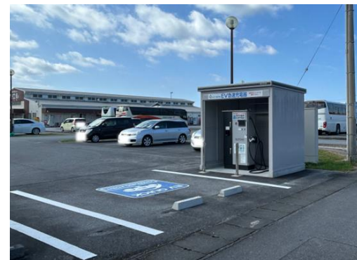
▲道の駅いとまん EV充電施設
