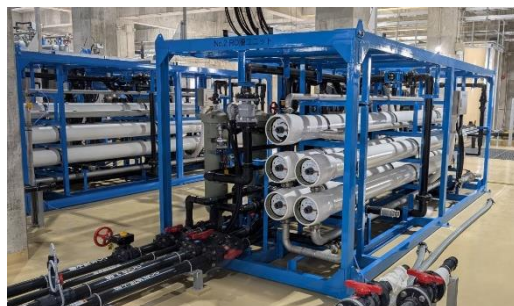
RO(逆浸透)膜設備
