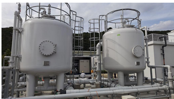
前処理ろ過設備
