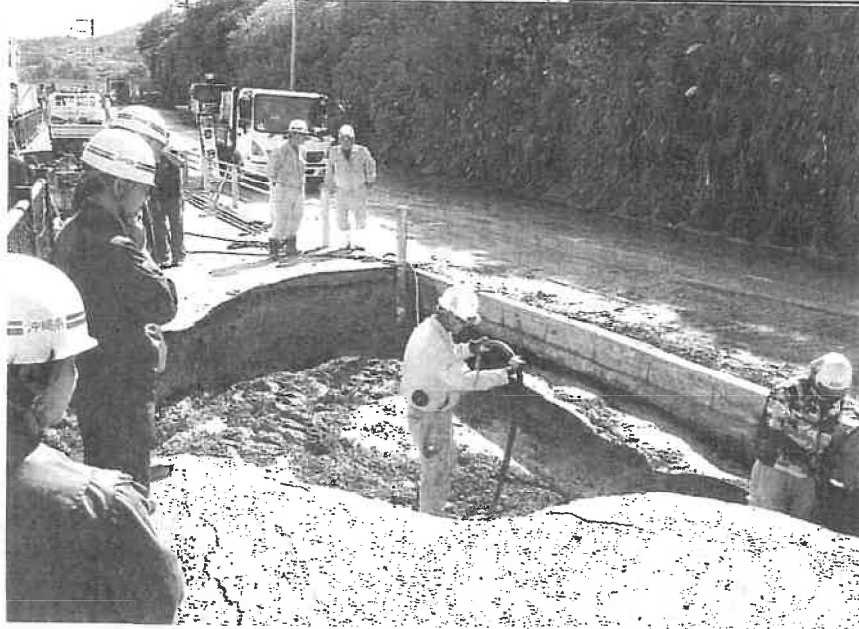
導水管の漏水で陥没した道路の補修工事をする作業員ら 24日午前11時20分頃、大宜味村
