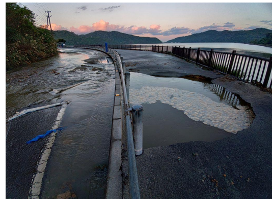
道路陥没状況
