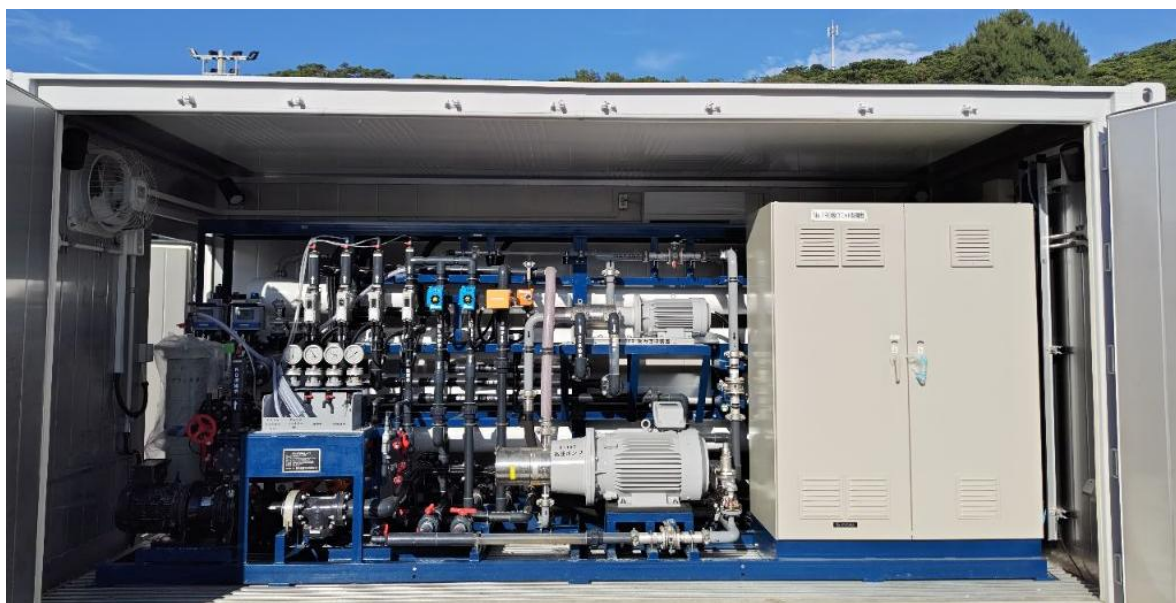
RO(逆浸透)膜処理装置
