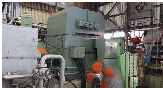
【蒸気タービン・発電機】
