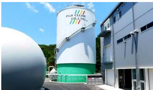
【乾式メタン発酵槽】
