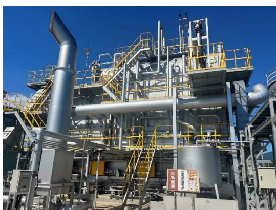
【バイオマスボイラー】
