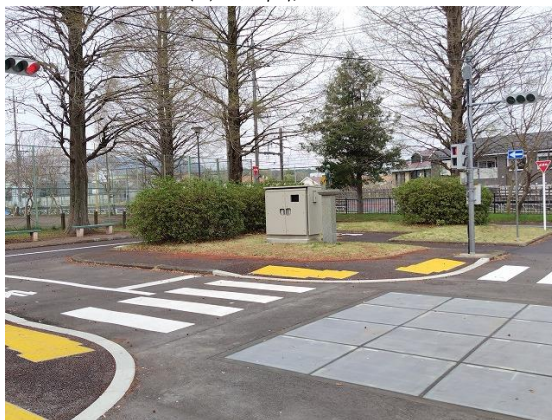
(c) 交差点路面太陽光パネルと電源監視制御盤
