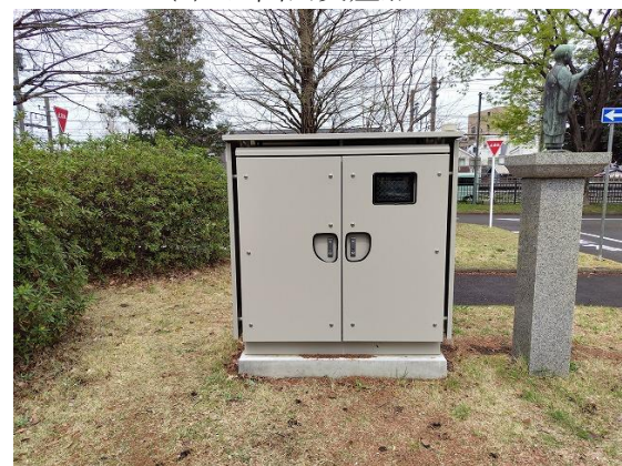
(d) 電源監視制御盤
