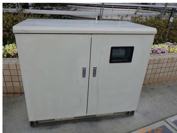
(b) 電源監視制御盤
