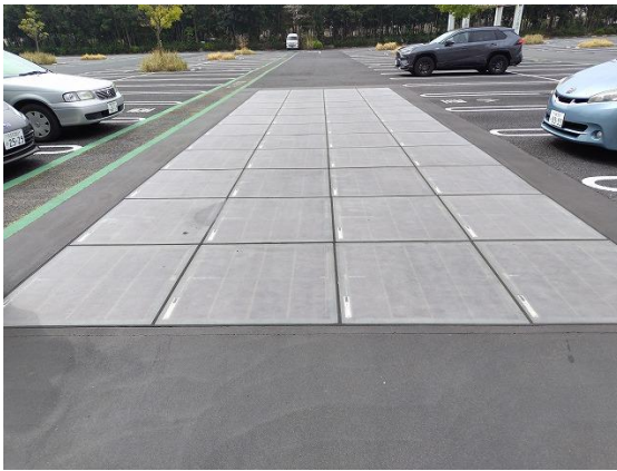
(a) 駐車場車道に設置されたパネル
