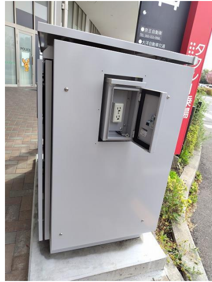
(b) 電源監視制御盤（蓄電池）
