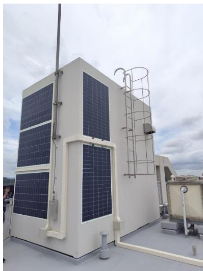
(a) 屋上壁面への設置
