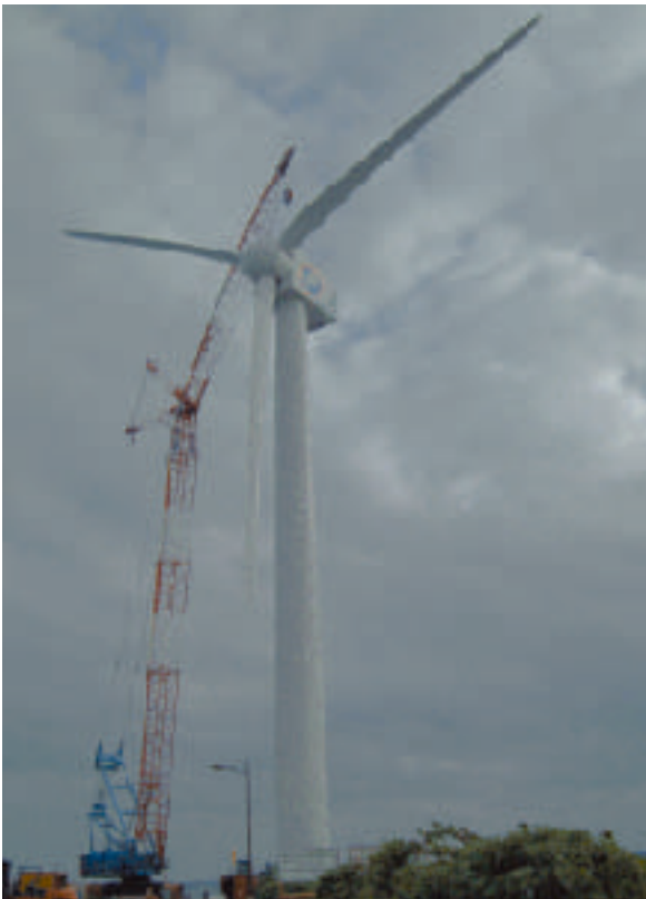
具志川風力発電所：単機出力1950kwを誇る日本最大の風力発電設備
