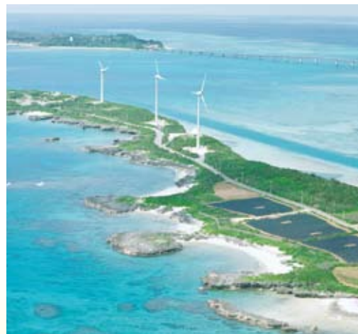
狩俣風力発電設備(沖縄電力(株))
