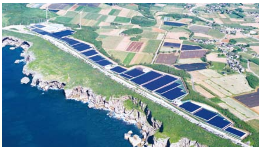
宮古島メガソーラー実証研究設備(沖縄電力(株))
