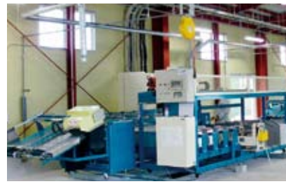
花き選別施設内に設置された自動選別機
