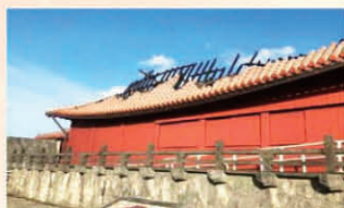
奉神門 応急復旧前
