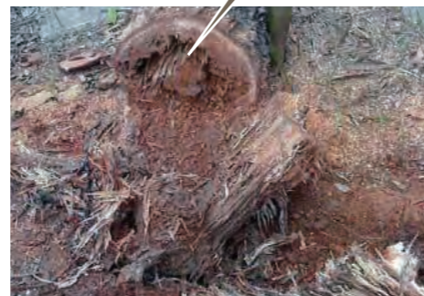
写真2 倒伏した樹木(シロアリの食害や腐朽等により幹折れしたコバノナンヨウスギ)
