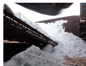
厩舎の損壊（北海道）
