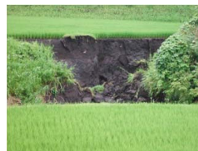
水田の畦畔崩壊（大分県）
