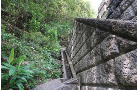
漢那ダム魚道
