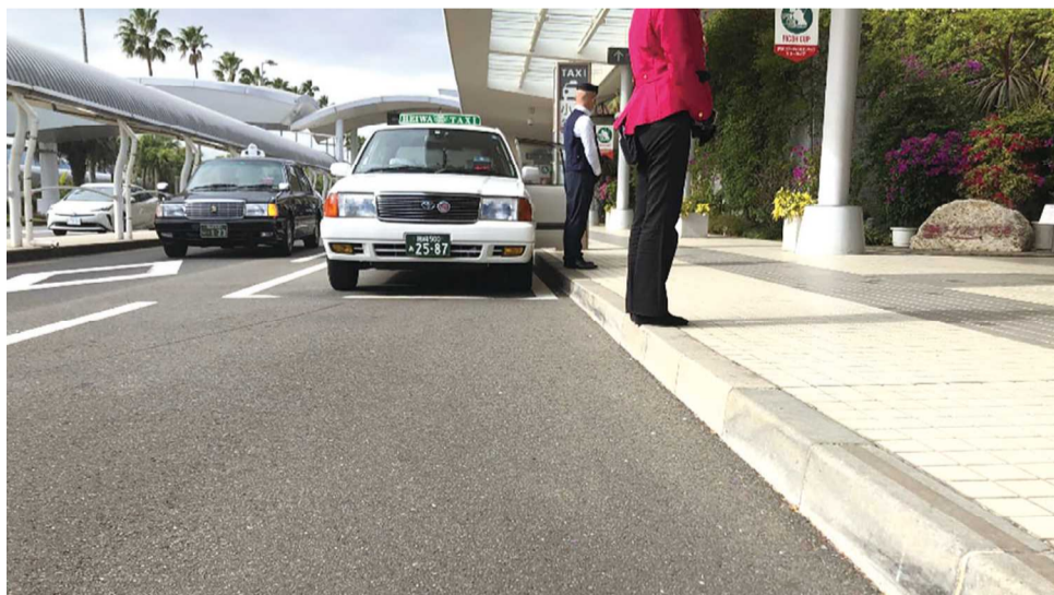
15cm程度の段差があり車道から歩道への上り下りが難しいタクシー乗降場
