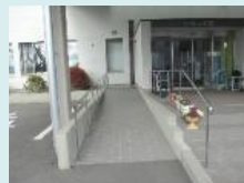
出入口の段差解消 事業費：30万円程度
