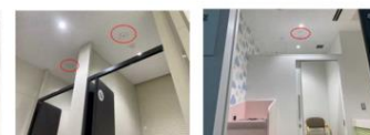
【密室空間となるトイレ（便所）と授乳室に光警報装置を設置】
