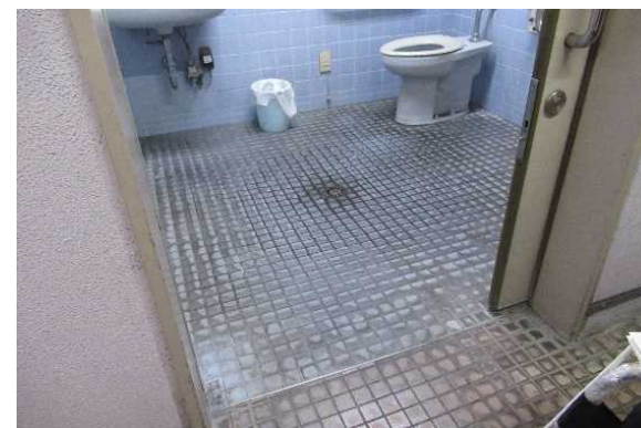
トイレ入口の扉が閉まりづらい オストメイト用の設備がない
