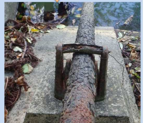
○取水施設の腐食(石垣ダム)
