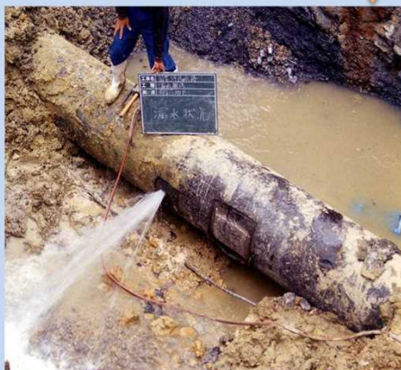
○管の腐食による漏水(宮良川地区)
