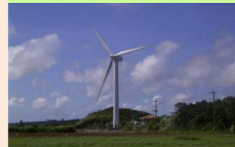
風力発電施設(宮古島市)
