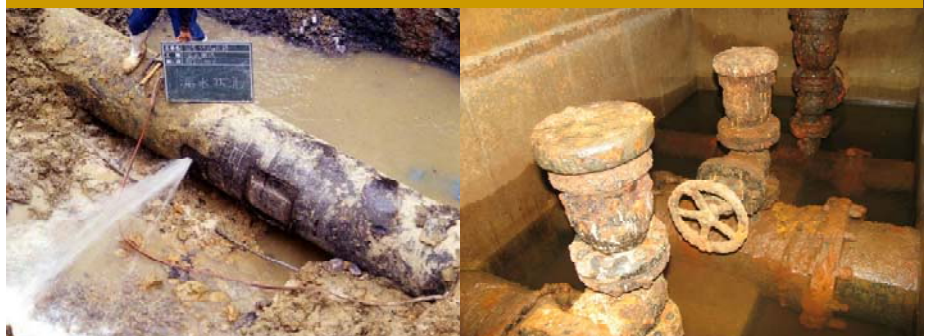
老朽化した施設
