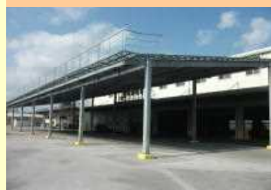
太陽光パネルの設置台（名護市）
