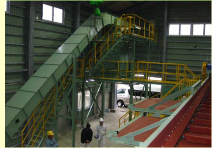
精脱葉施設内部の状況
