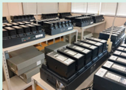
バッテリー保管・充電施設
