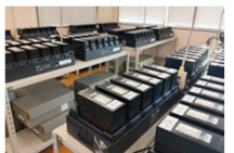
ドローンのバッテリー充電施設
