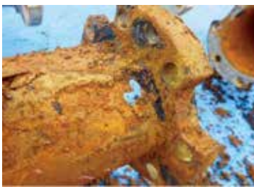
取水施設の揚水管腐食状況
