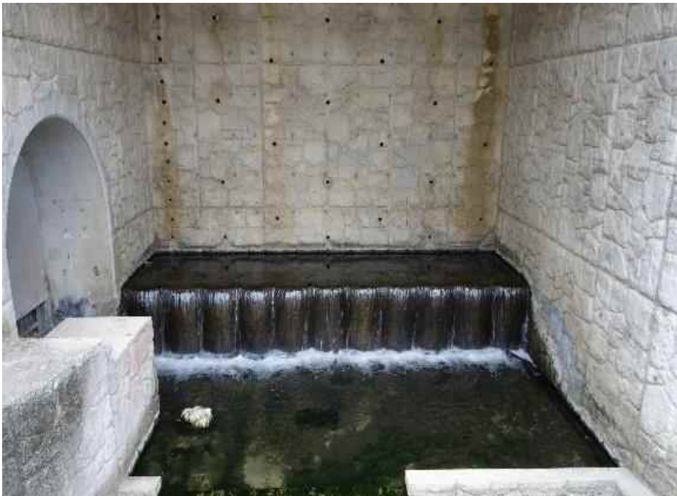
きいざ 【慶座地下ダム水位観測施設】
